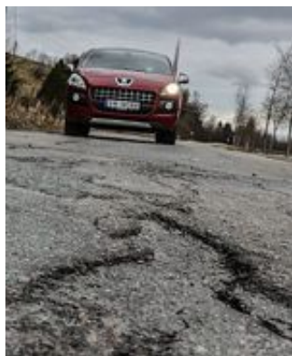
Fra Fylkesveg 26 sørsida av Stjørdalselva der asfalten sprekker opp.
